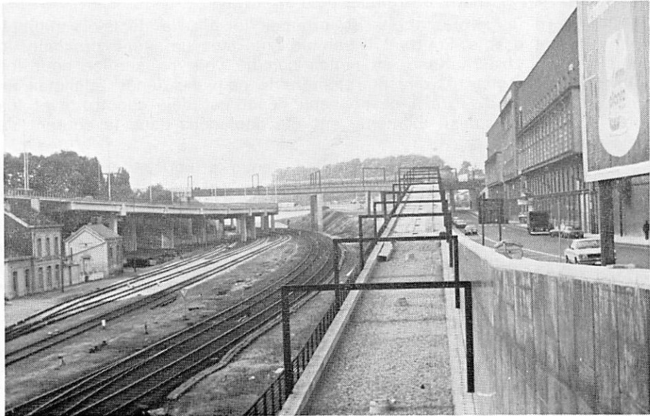
Future assiette du semi-méto de Charleroi. A gauche dans le fond, on aperçoit le Pont en direction de la station « Les Piges ». (Photo W. Hoste, le 20/6/78) Toekomstige bedding van de semi-metro te Charleroi. Links, op de achtergrond, merkt men de brug, in de richting van het station « Les Piges ». (Foto W. Hoste, 20-6-78)
